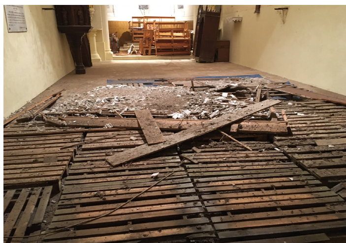
photo du sol après l'effondrement
